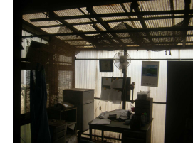
現況写真[工場内部]
