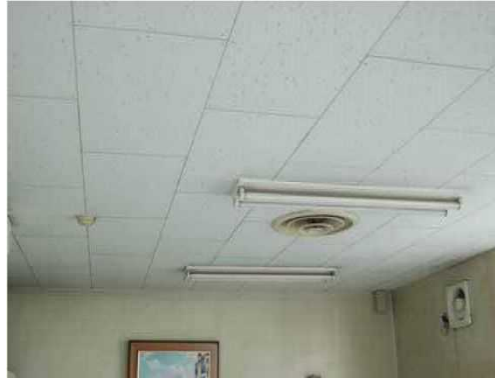
アスベスト含有ロックウール吸音板（天井）
