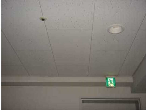
アスベスト含有石膏ボード（天井）
