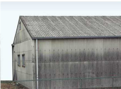
アスベスト含有スレート波板（屋根）
