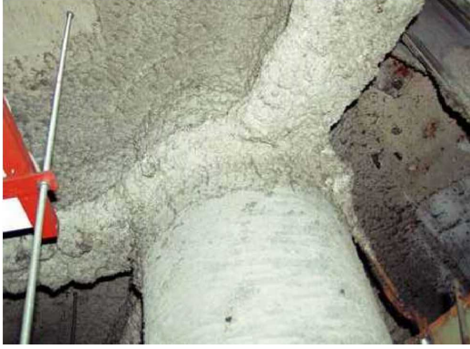
吹付けアスベスト (梁)
