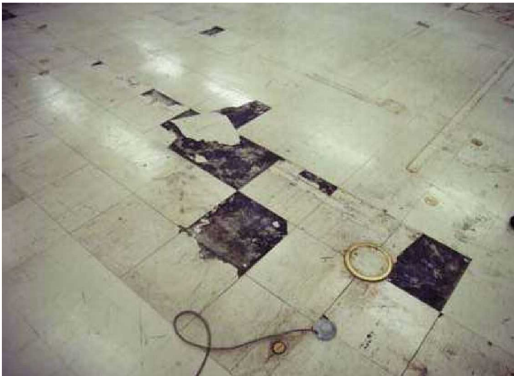
アスベスト含有ビニル床タイル（床）
