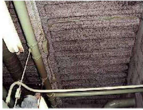
アスベスト含有吹付けロックウール (天井)
