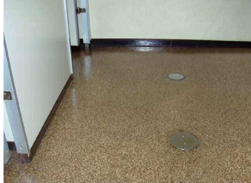
アスベスト含有ビニル床シート（床）
