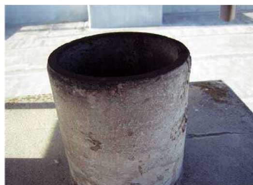
アスベスト含有煙突用断熱材 (煙突)
