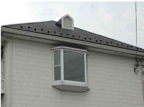
アスベスト含有窯業系サイディング（外壁）
